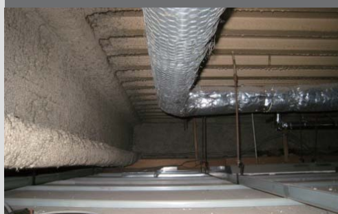
天井裏の吹き付けアスベスト
